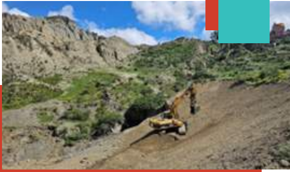
Fotografía. Río. Kupini I y III (Zona Kupini Central). Intervención con maquinaria, conformación de banquetas para la estabilidad del talud por la pérdida de barreras transversales de gaviones, poniendo en vulnerabilidad a viviendas y tránsito vehicular y peatonal a la zona de Obrajes, altura calle 17.
