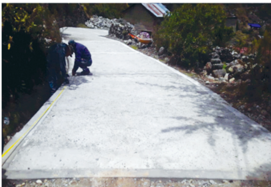
MEJ. VIAL TRAMO INGRESO A LA COMUNIDAD A CURVA U. EDUCATIVA DE PROG. 0+250 A PROG. 0+300 COMUNIDAD LLAULLINI
